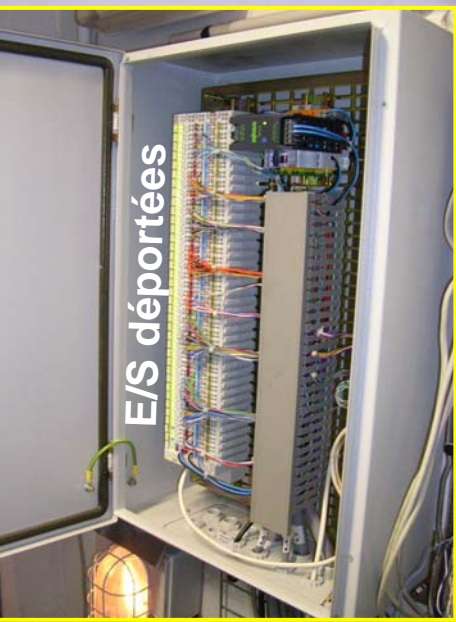
Coffret E/S déportées ETHERNET
