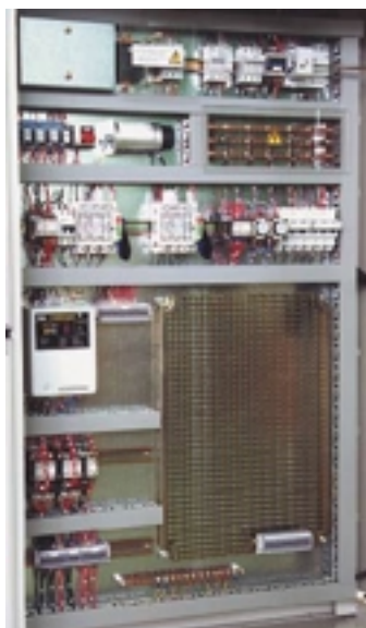
Fig. 2 : armoire ouverte avec grille de câblage vierge montée
